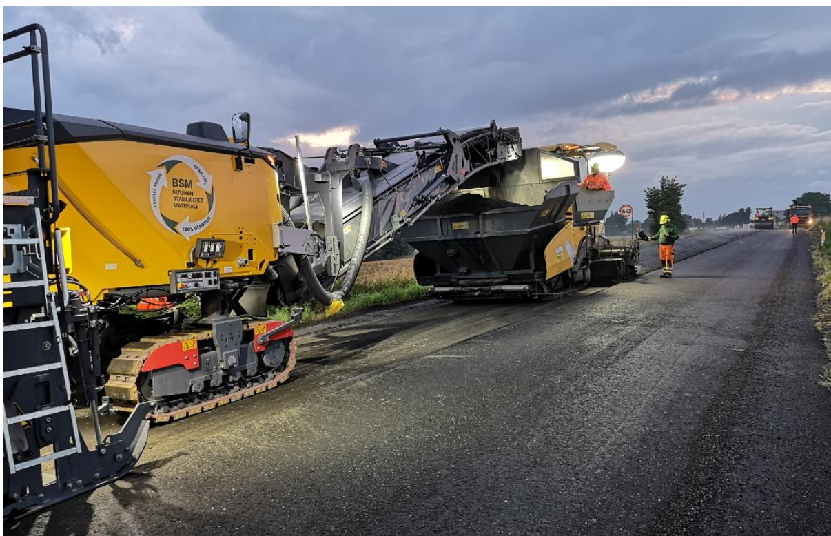
Fig. 4.4: Efter CRI-maskinens forvandling af gammel asfalt til ny BSM in-situ, blev den friske BSM udlagt med en bagvedkørende traditionel asfaltudlægger.
